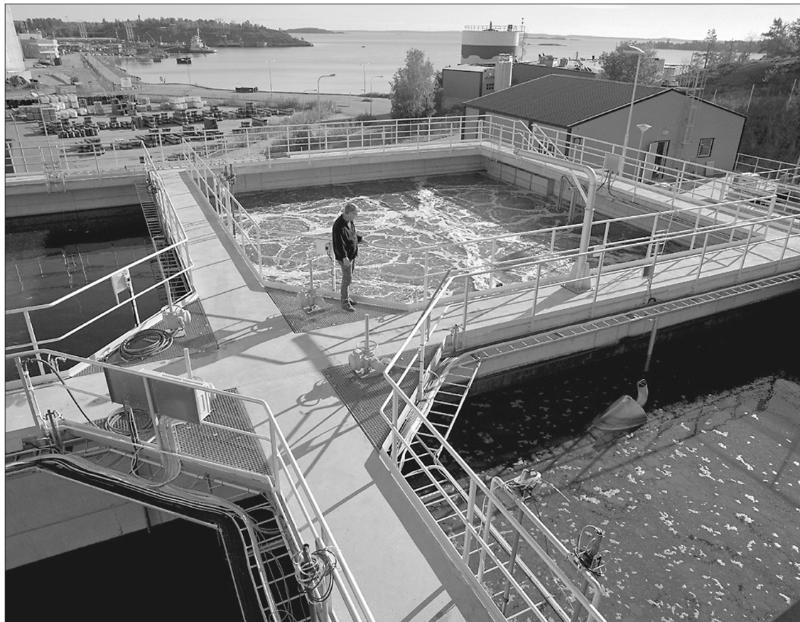
Figur 1. SBR-anläggningen vid Nynäshamns reningsverk.
