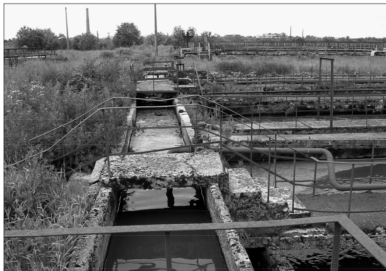
Figur. 2. Inloppsdel vid Volkhov avloppsreningsverk utanför St Petersburg, foto taget av Rolf Ahlström 2002.
