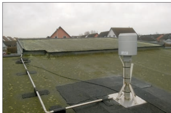
Figur 2. Takinstallation av regnmätare Lambrecht.
