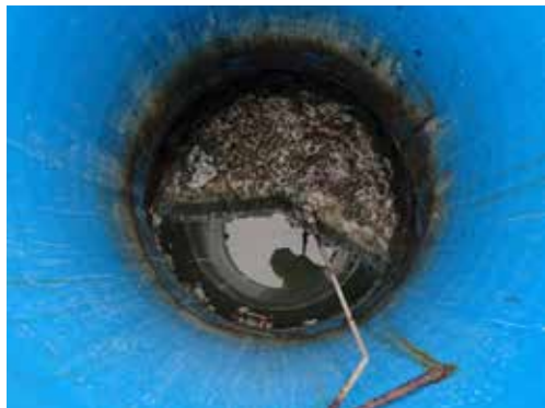
Figur 19. Exempel på anläggning med stora mängder slam i fördelningsbrunn.
