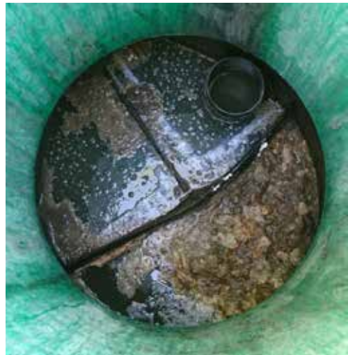
Figur 1. Denna anläggning dämmer i den övre delen så att det precis rinner över mellanväggarna i slamavskiljaren.
