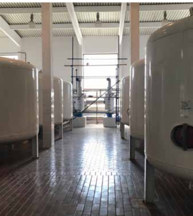
Figur 2. Sandfilter i Vodozahvat I, Subotica.
