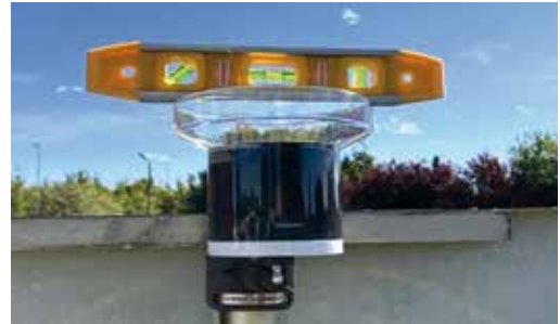
Figur 2. Installation av regnsensor Netatmo på ARV Trelleborg – vågrätt i axel med vippan.
